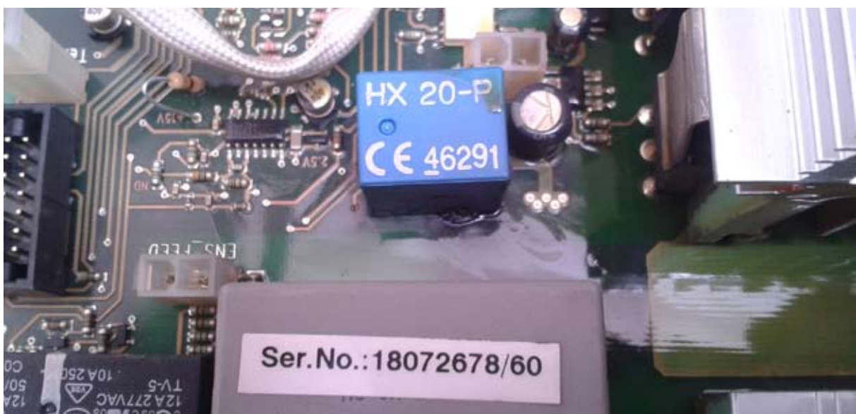
Placa de uno de los inversores de la Ola Solar del Mercat del Carmel que fue substituida por estar averiada por una sobrecarga en la red eléctrica.
